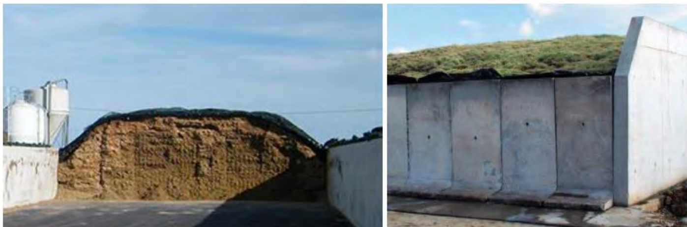
Exemple de stockage couvert et cloisons préfabriquées amovibles
