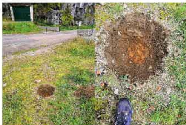
Figure 4 : Avant trou du sondage 5 : pas de film d'étanchéité observé au-dessus des résidus oxydés
