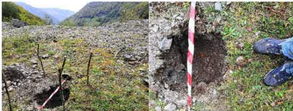
Figure 3 : Avant trou du sondage 4, pas de film d'étanchéité observé.
