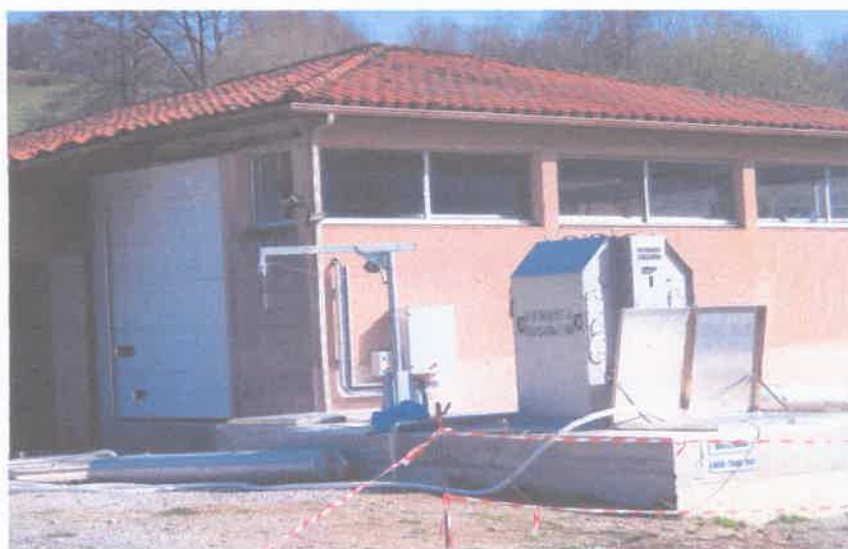
Le dégrilleur, nouvel équipement entre la prise d'eau et l'usine.
