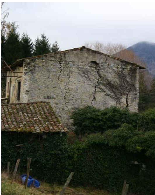
Photographie 8 : Maison dont la partie est du terrain (lavoir) est affectée par un glissement de terrain, lieu dit Montplaisir (Source : AGERIN)
