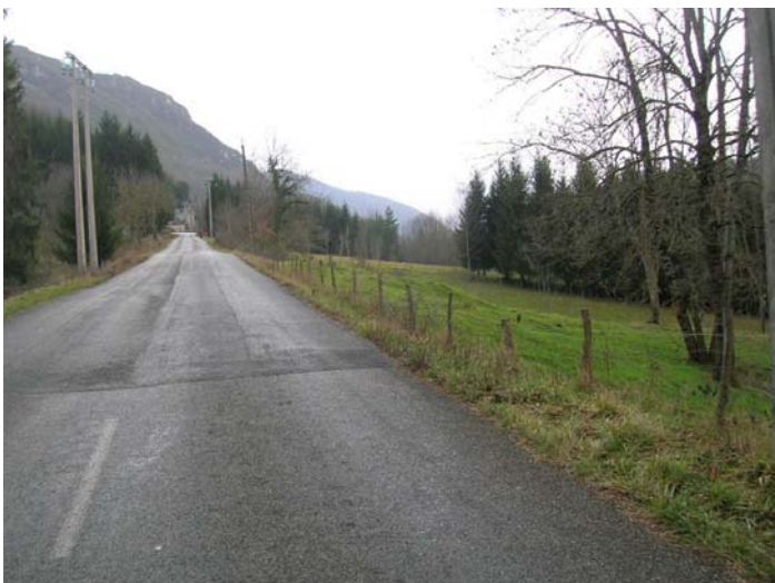
Photographie 6 : Glissement de terrain en bordure de la D16 (Source : AGERIN)
