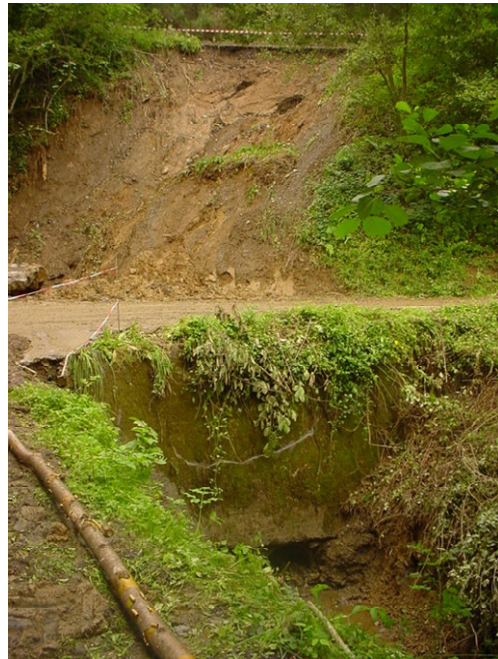
Glissement du talus amont de la Rd 3 - 2002
