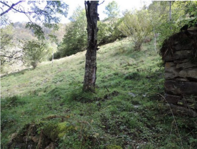
Glissement de terrain en pied de versant saturé par les apports de ruissellement de versant - rive droite du Cougnet à Loumateix
