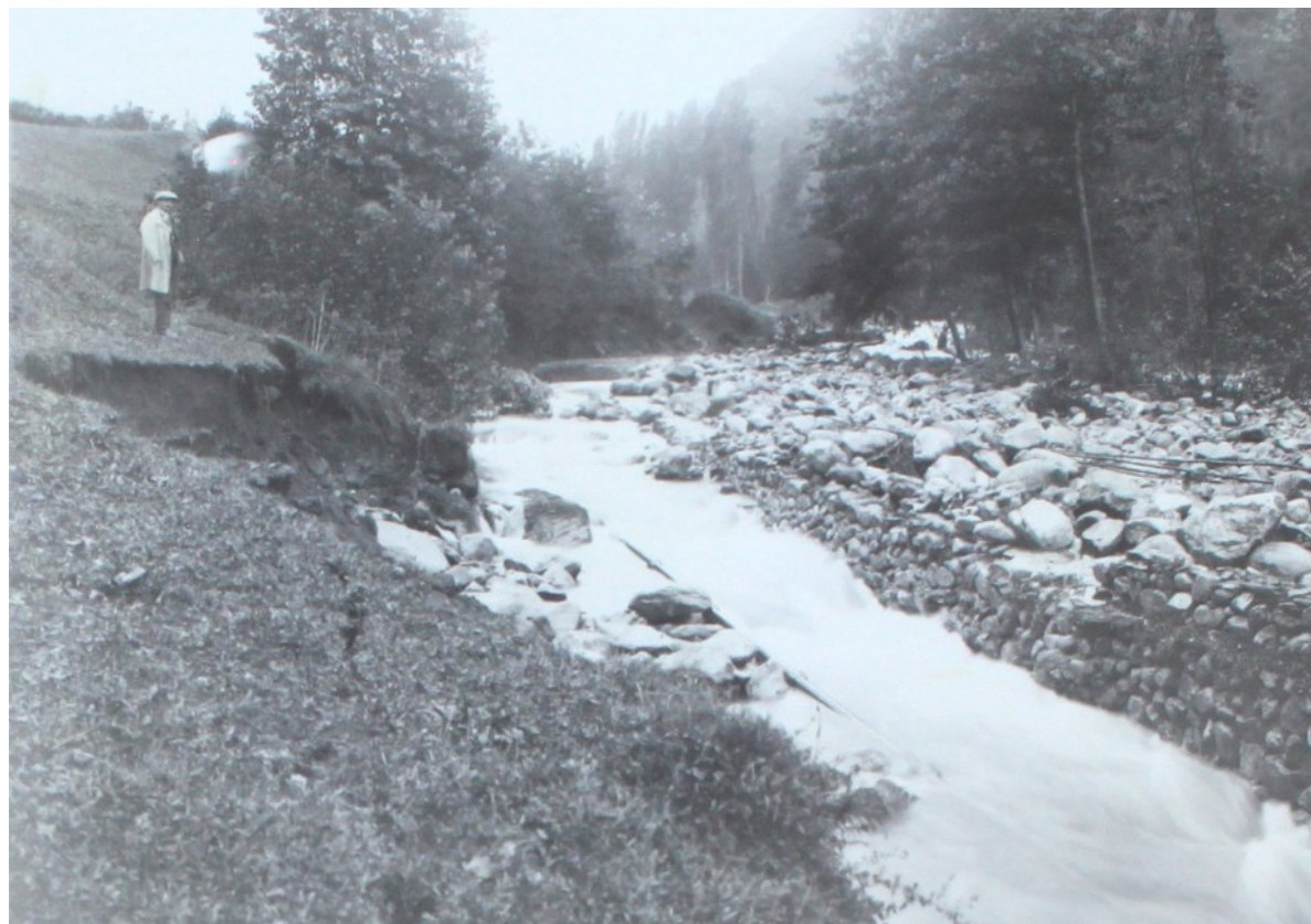
Source : Déclaration des dégâts par la commune (AD 09 -7M15) La route emportée – les canalisations des fontaines apparaissent
