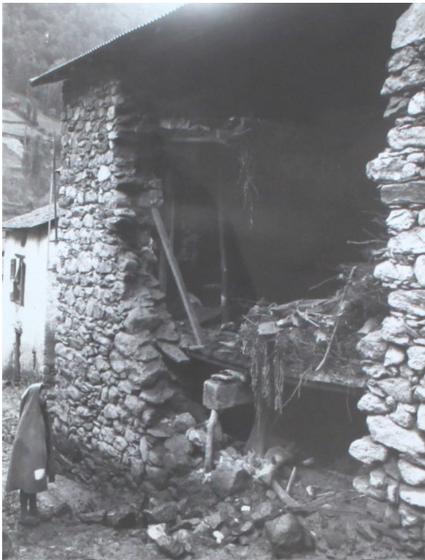
Maison éventrée par l'inondation
